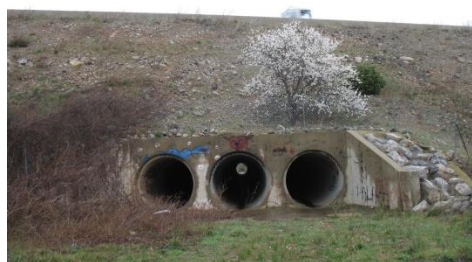
☞ Photographie : Passage à trois buses sous l'autoroute, peu fonctionnel
